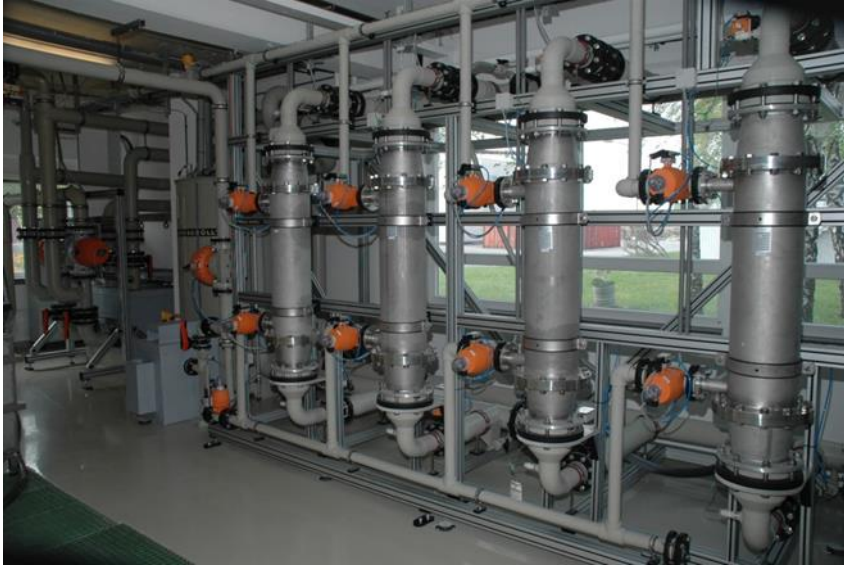
Abbildung 6: Filtriereinheit der Ultrafiltrationsanlage
